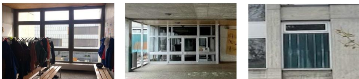
Figure 4 : constat de sécurité des vitrages
